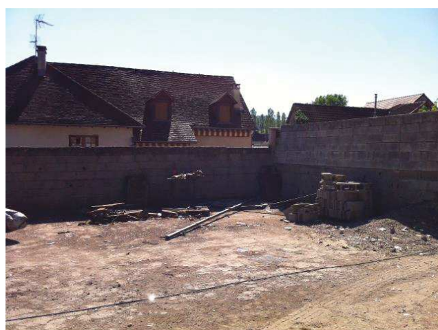
Zone avec dalle en mauvais état
